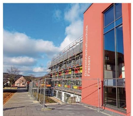
Noch steht ein Gerüst am neuen Anbau der Gemeinschaftsschule. Das soll aber bald verschwunden sein. FOTO: MELANIE MAI
